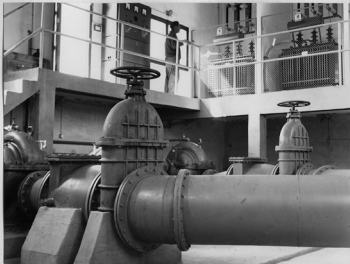
Estación de elevación de agua del río Ebro, para el riego de la zona de Arguedas — Tudela (Navarra).
